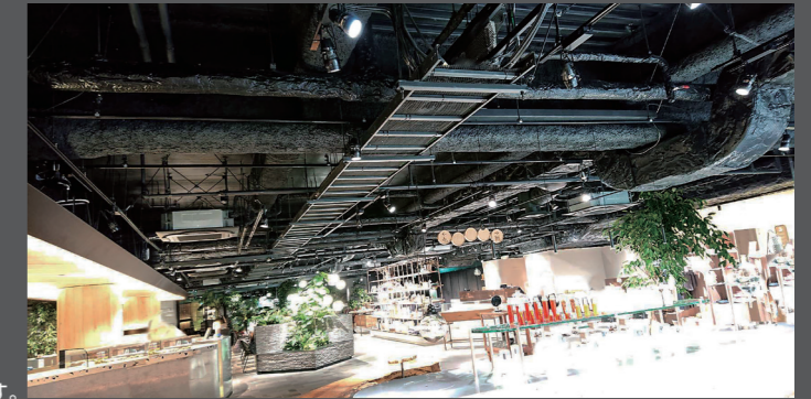
GOOD NATURE STATION(京都府京都市) 黒ZAM。製ケーブルラックが魅せる電路支持材として優れた意匠性を発揮しています。
